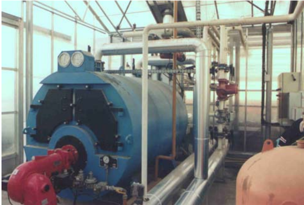
système de chauffage au gaz naturel (réseau haute température) Hor en val – Dampierre en Burly (F)
